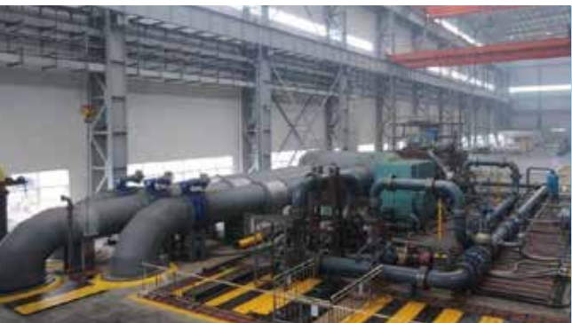
重型车间 大型泵测试台
